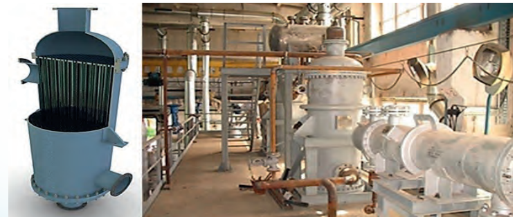
Unité modulaire pour convertir le gaz naturel et le gaz de colonne de production en pétrole synthétique
